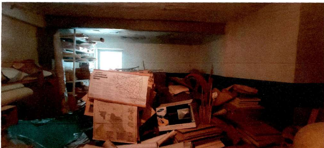
Рис. 16. Загальний вигляд приміщення машинного відділення
