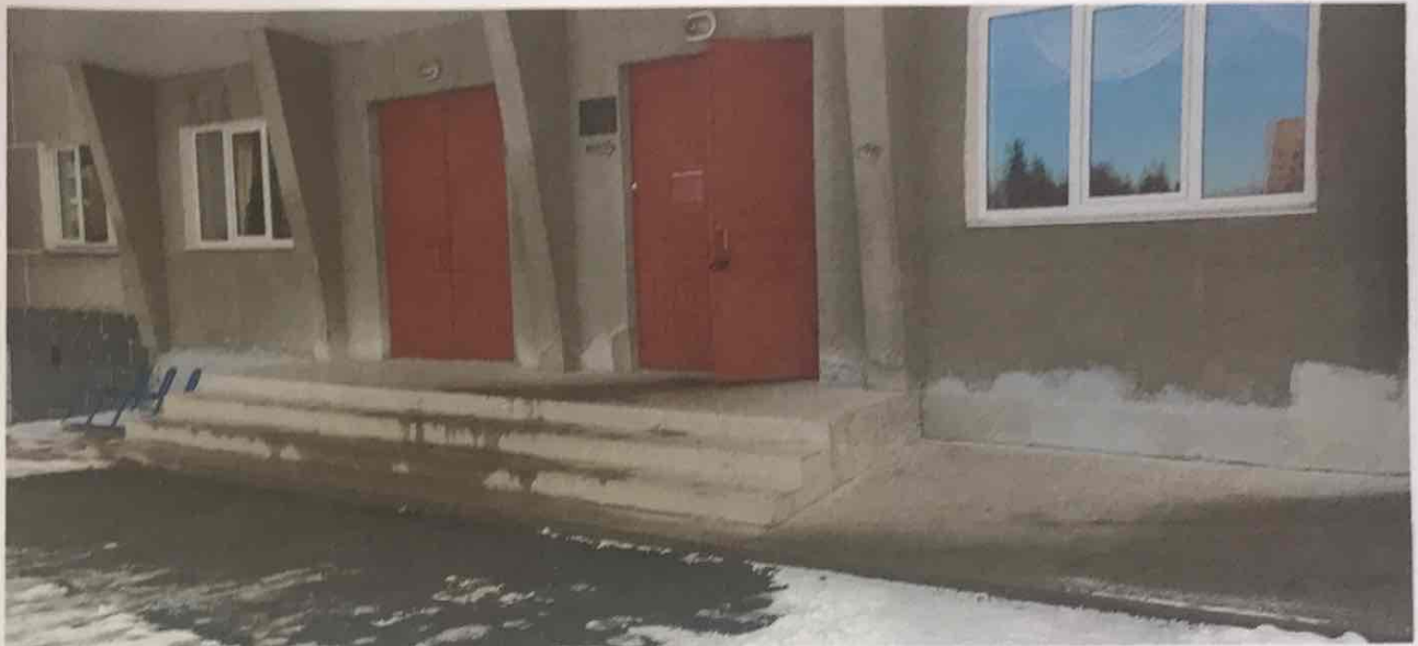
Рис. 4. Загальний вигляд сходів біля входу в гуртожиток
