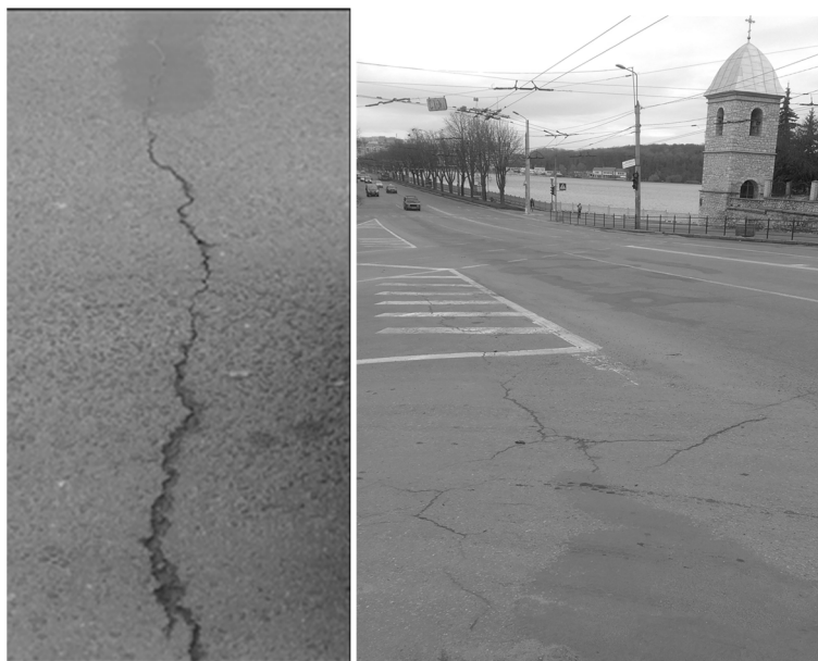
Рис. 3. Тріщини на асфальті (вул. Руська)
