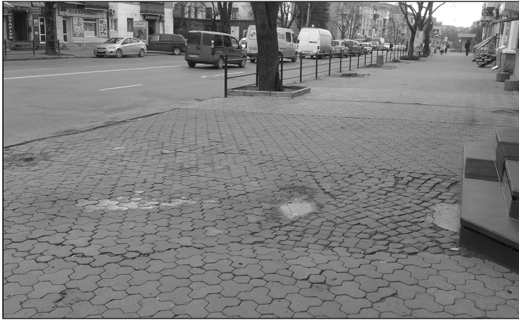
Рис. 4. Просадка на тротуарі (вул. Руська)
