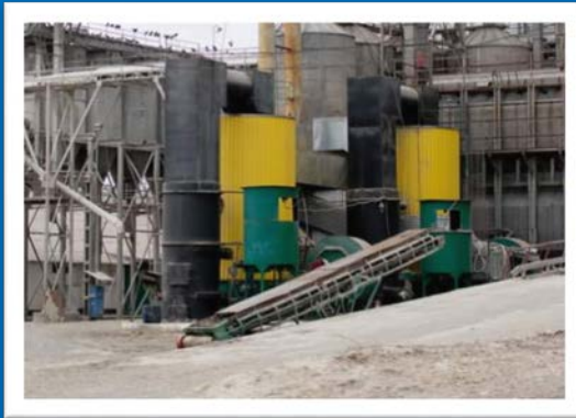
Теплогенератор потужністю 2 мВт
