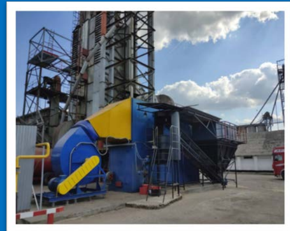
Теплогенератор потужністю 3 мВт
