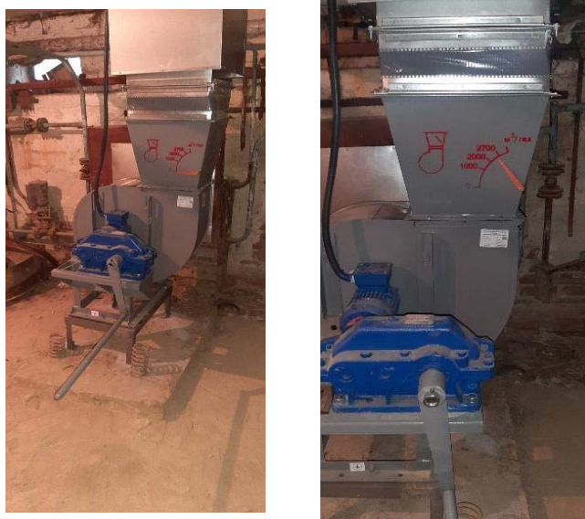
Рис. 10.7. Електро-механічний вентилятор ПРУ (гуртожиток № 5)
